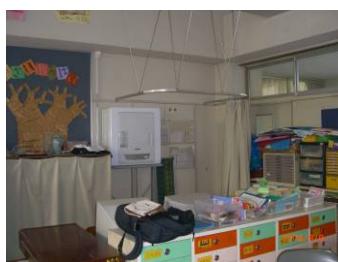
写真3 仲良し教室 空調設備
