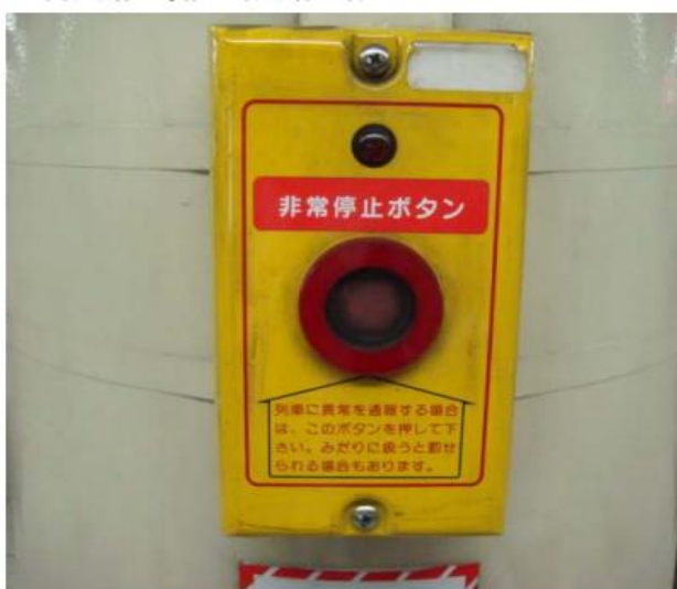
図 10 非常ボタン(列車非常停止装置) (出典 国土交通省鉄道局 2010)
